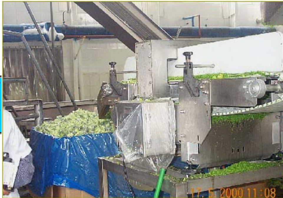
Detector de metales para líneas de proceso (flecha amarilla)
