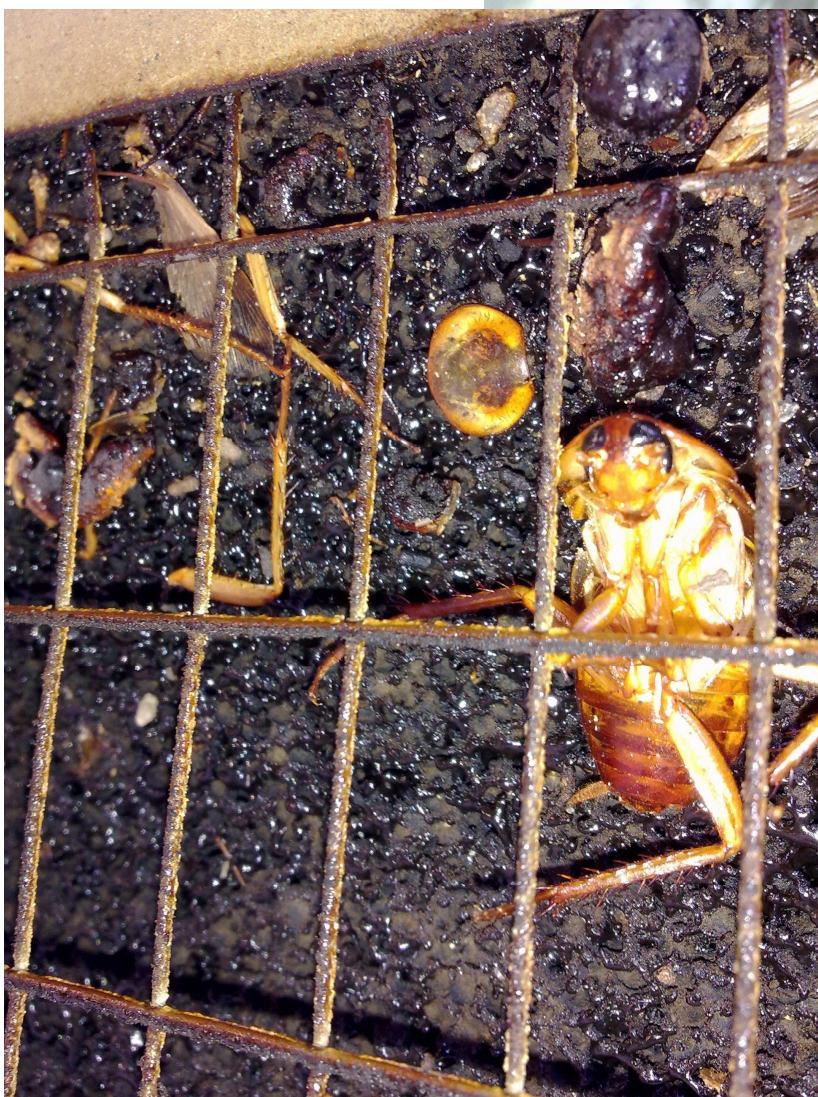
Imagen nº 16. Filtro de carbón activo con cucarachas.
