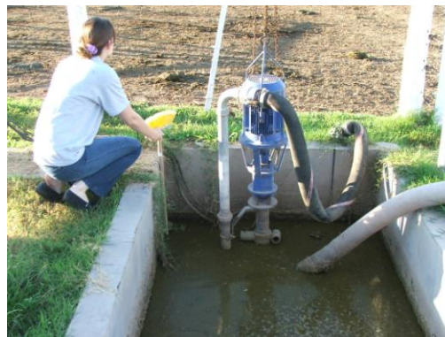
Foto 2: Cámara de almacenamiento temporario.
